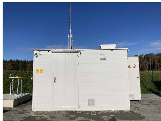
Abbildung 11. links: H 2 -Einspeiseanlage von innen inkl. Druckregelung; rechts: Außenansicht der H 2 -Einspeiseanlage
