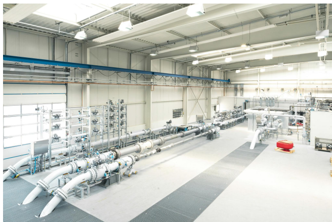
Abbildung 10. Der H 2 -Loop der Firma RMA in Rheinau. Bild © WD GmbH – Werbung & Design
